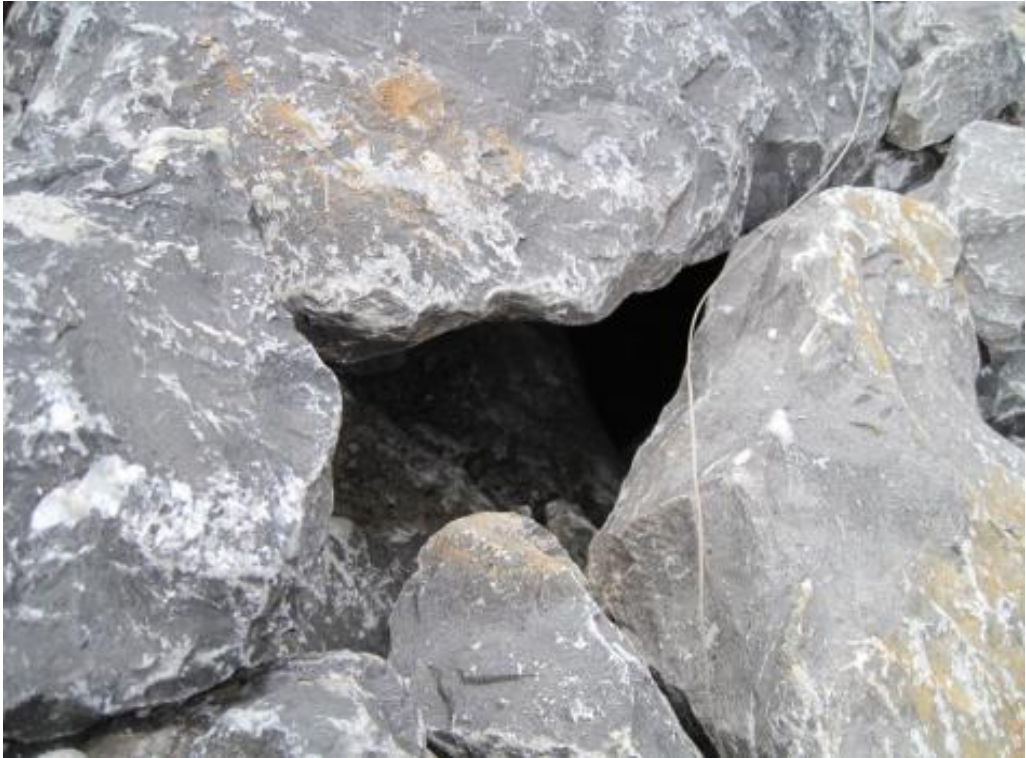
质量管理图 1-2 排水棱体干砌块石砌筑质量不符合要求，干砌块石架空 备注：现场图片既要拍摄工程整体状况，也要拍摄重点部位的细部情况，可在其中圈出关键部位，图片务必清晰、准确、真实
